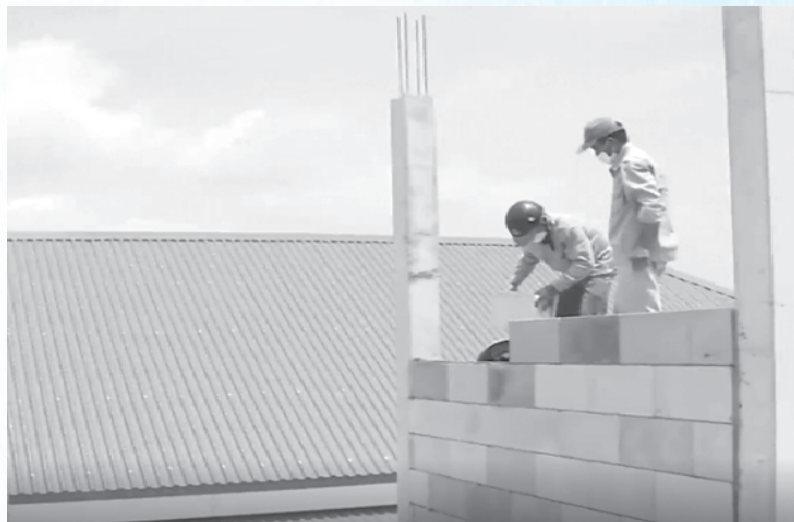
Công trình nhà ở của chị Trần Thị Nguyệt, xã Thạch Hưng đang được lắp ghép hoàn toàn bằng loại gạch không nung lõi xốp; ảnh: PV
